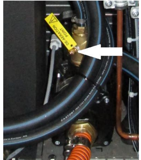
(Point de désaération)
